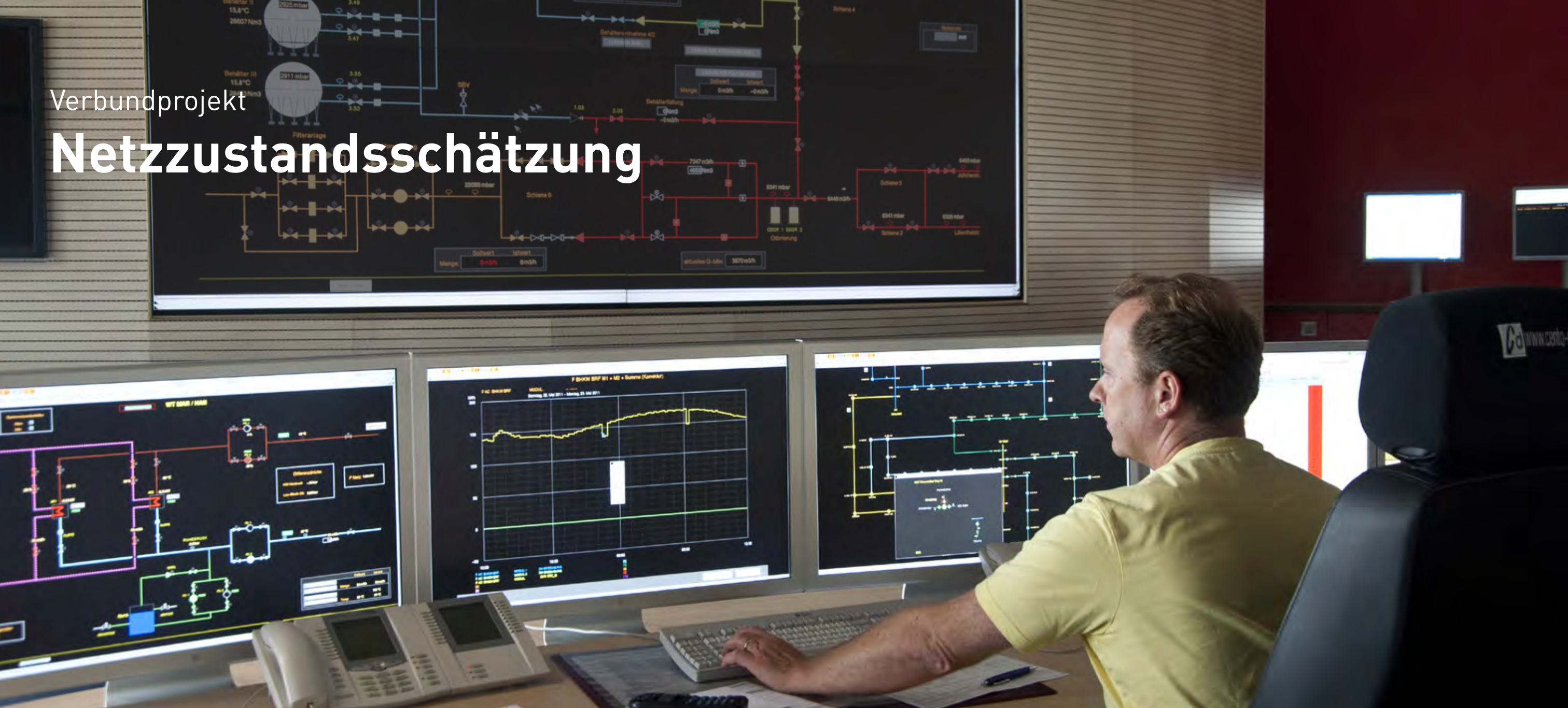
Abbildung 47: Netzleitstelle der STAWAG
