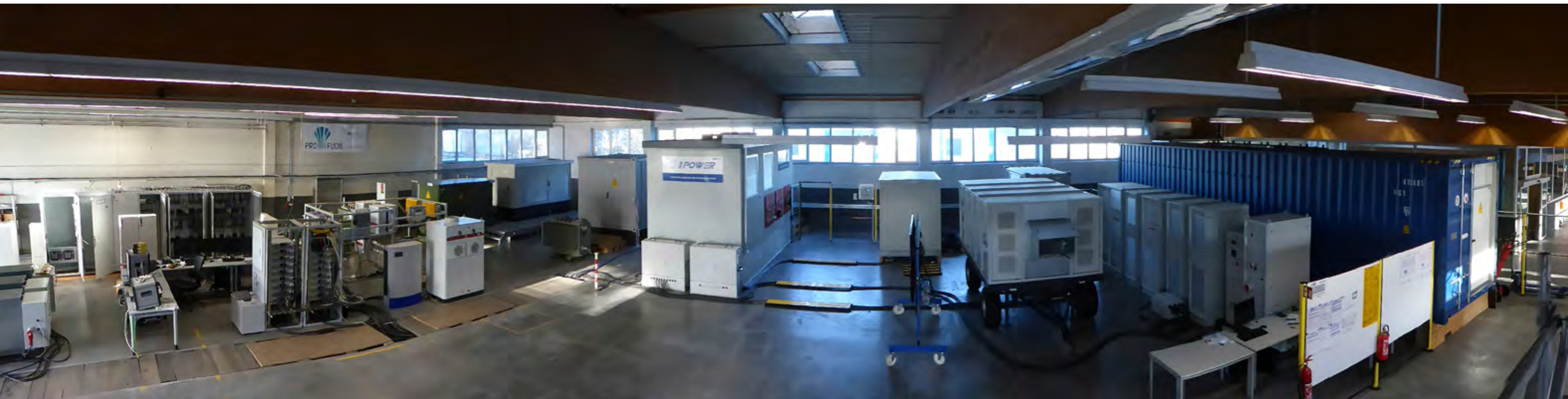
Abbildung 30: Laborübersicht, links Wechselrichter und Laborsteuerung, mitte Netzstationen, rechts Niederspannungsnetzsimulator und Spannungseinbruchstestsystem; IFHT
