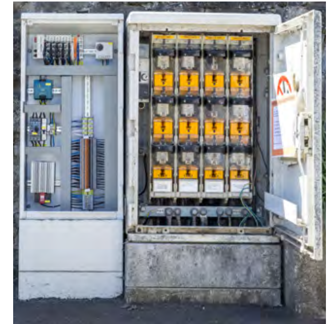
Abbildung 27: Abgesetzter Sensor neben Kabelverteilerschrank
