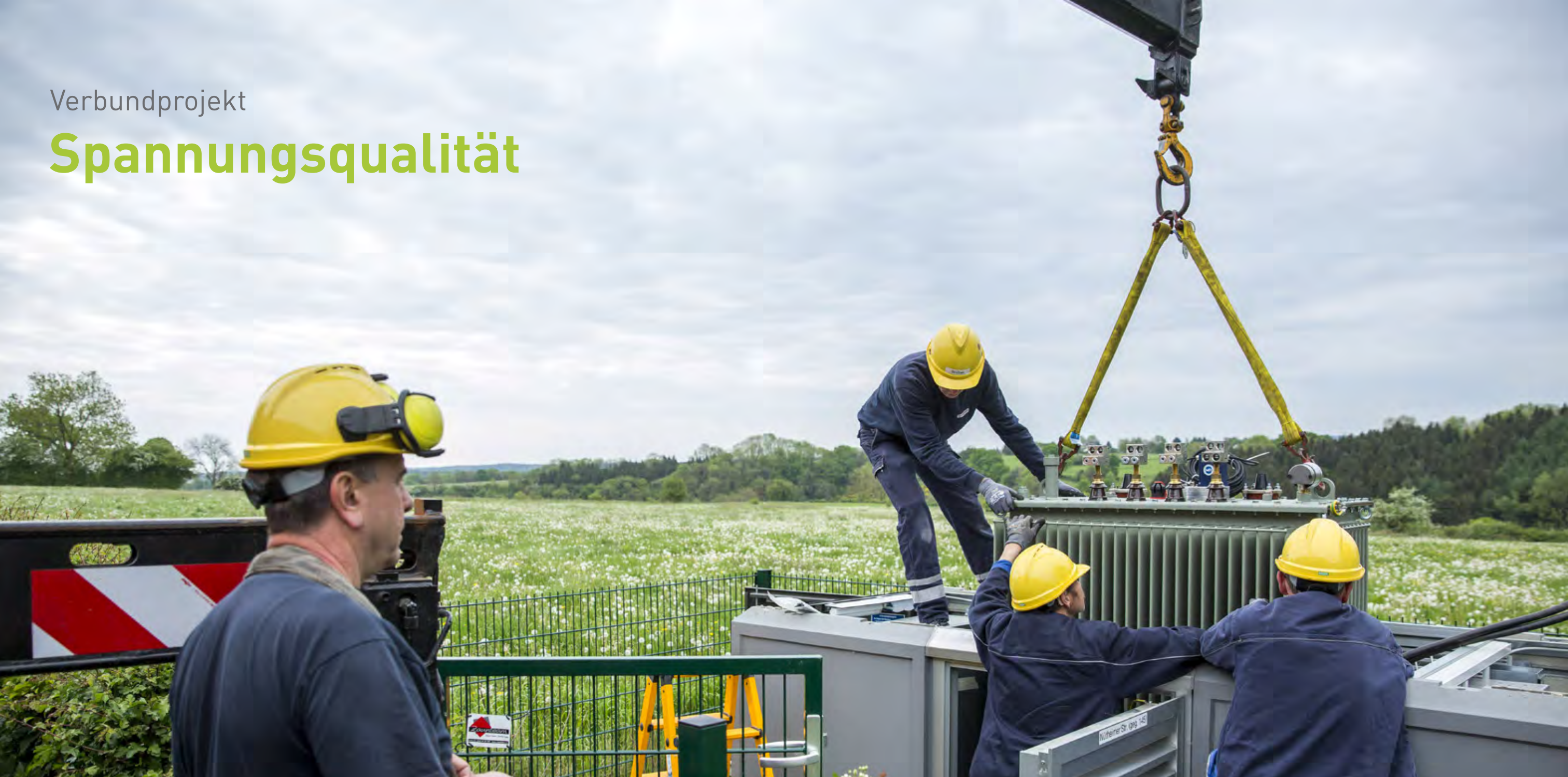
Abbildung 25: Einbau rONT in Ortsnetzstation, Nütheimer Straße (Aachen)
