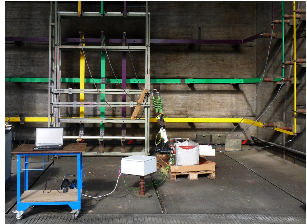
Versuchsaufbau für MS-Fehlererkennung bei FGH (Quelle: ABB)
